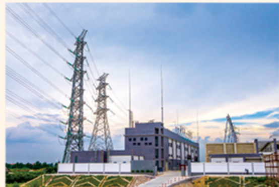
220千伏熙悦变电站顺利投运。
